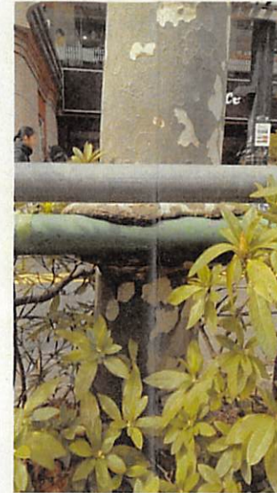
No.14 防護柵のみこみ
