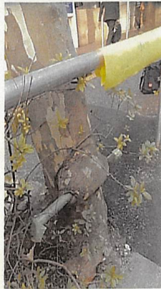
No.3 防護柵のみこみ
