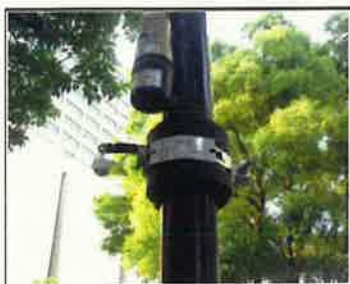
設置状況(街路灯)
