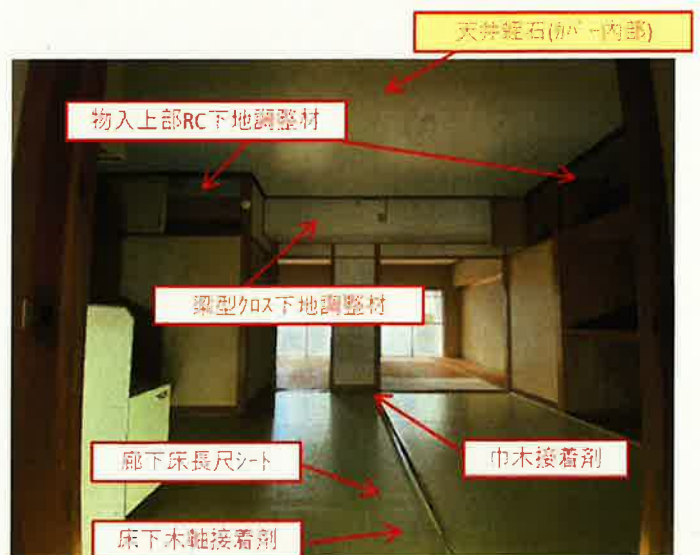
【区営四番町アパート住戸内 石綿含有建材(例)】
