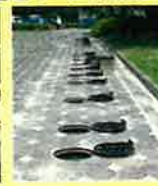
マンホールトイレ（広場に設置）
